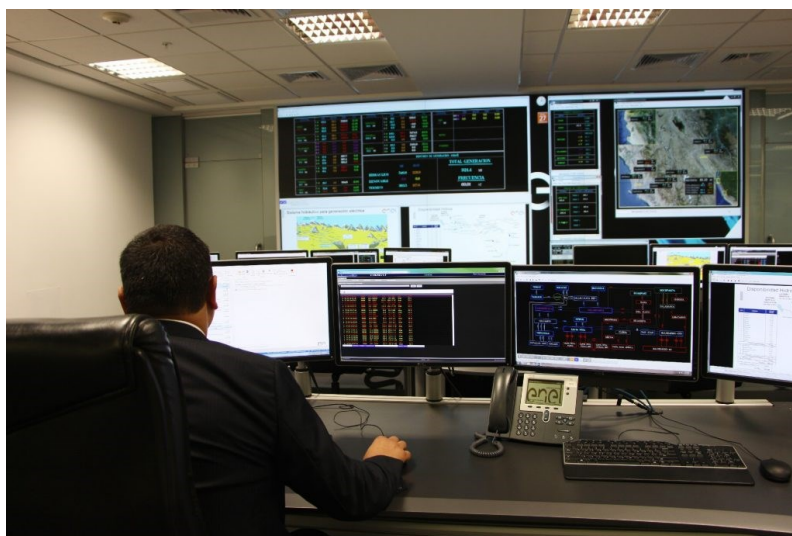
Figura 57: Disposición de monitores de una Sala de Control incluyendo al operador del proceso
