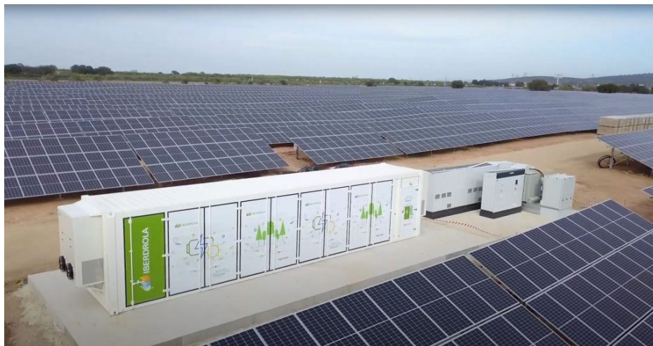
Figura 53: Disposición de un inversor en una central solar fotovoltaica
