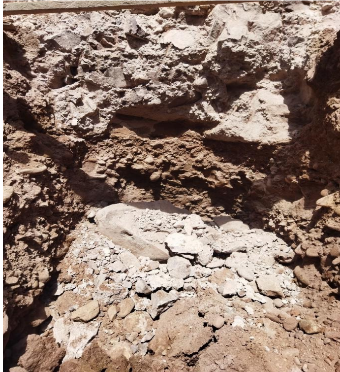
Foto 11: Perforación y rotura de bloques de concreto de la cimentación antigua en bloques de forma irregular y macizo.
