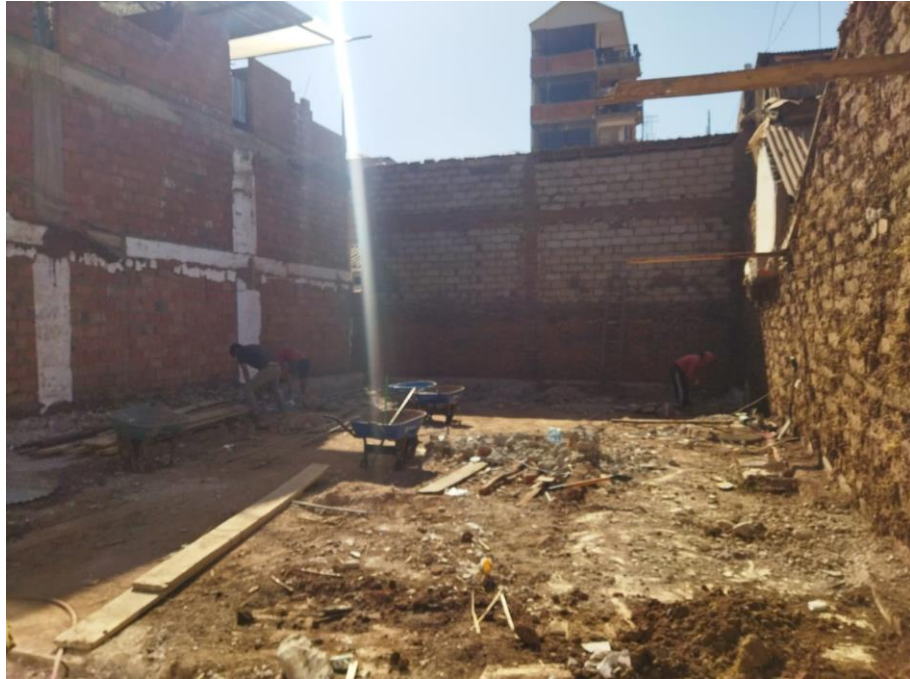
Foto 10: Verificación de niveles de terreno para continuar con el retiro de estructuras de cimentación de la edificación antigua.
