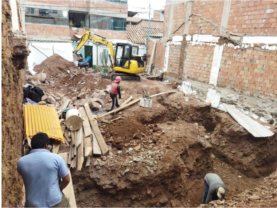
Foto 13: excavaciones de terreno para el retiro de bloques de cimentación existente con maquinaria liviana de excavaciones.
