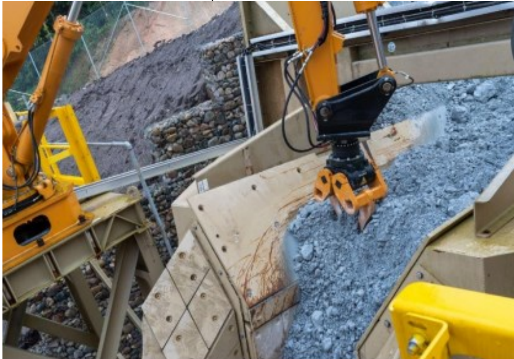
Figura 23 Maquinaria de extracción
