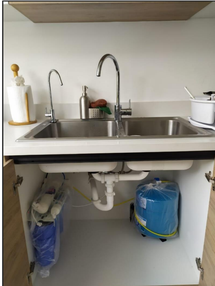
Figura 3 Sistema de ósmosis inversa 5 pasos instalado
