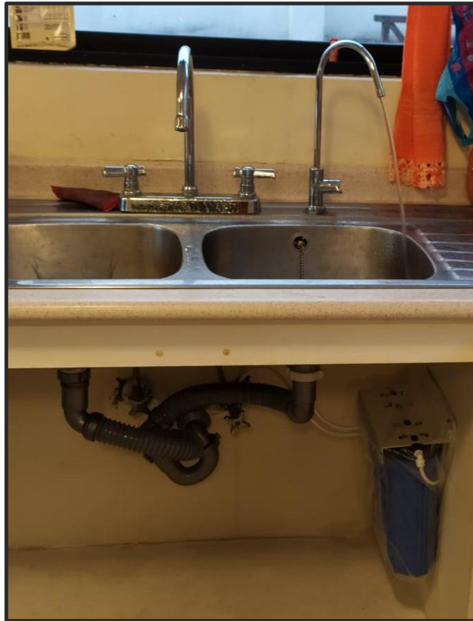
Figura 4 Sistema de filtración de 2 etapas
