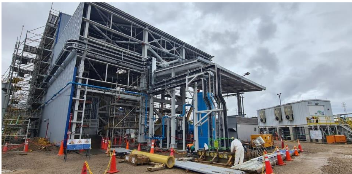
Instalaciones de Planta de Cal en Yanacocha
